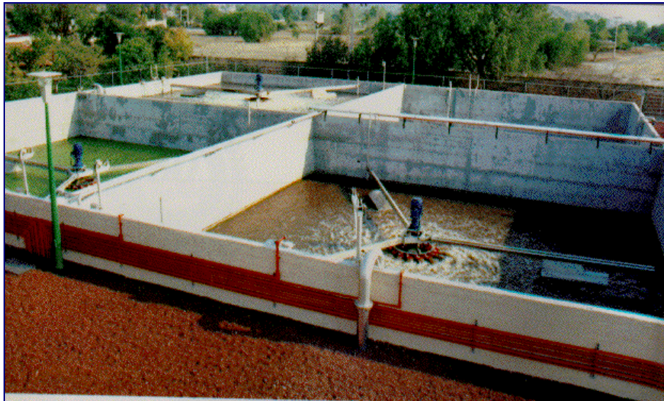
Figura J.2 Planta de tratamiento de aguas Tangamanga 1 Vista de su área de turbinas de agitación mecánica
